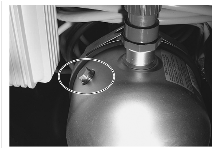
Резьбовая пробка вентиляционного отверстия на насосе охлаждающей воды
